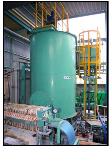
▲廃水処理設備
